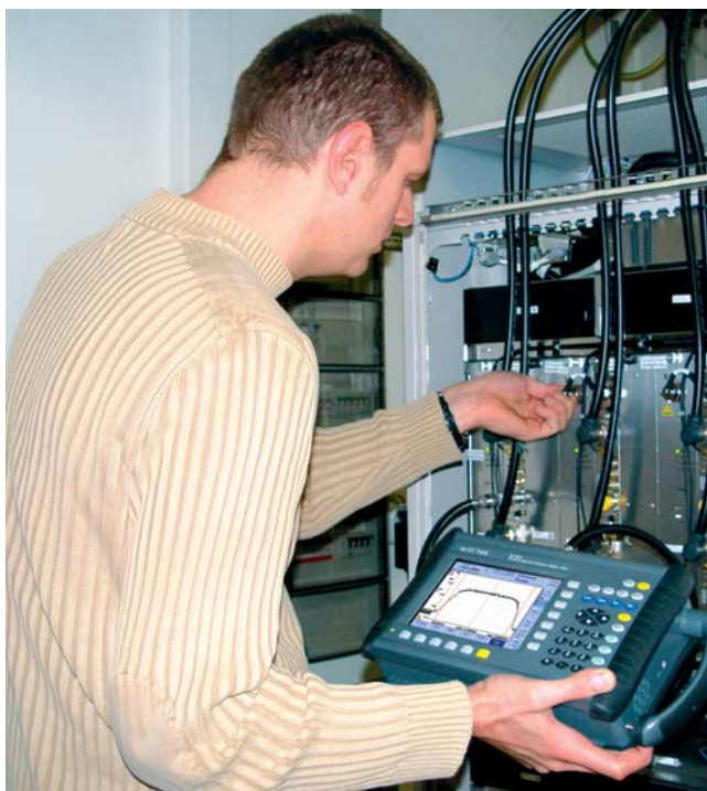
Medidas de potencia de canal en un UMTS Node B
